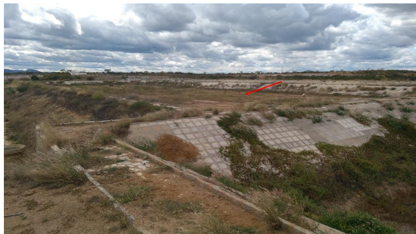
Foto 02. Serviços de impermeabilização no fundo das lagoas facultativas inacabados.
