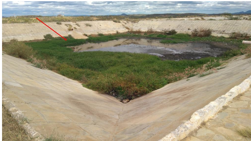
Foto 01. Serviços de impermeabilização no fundo da lagoas anaeróbicas inacabados.
