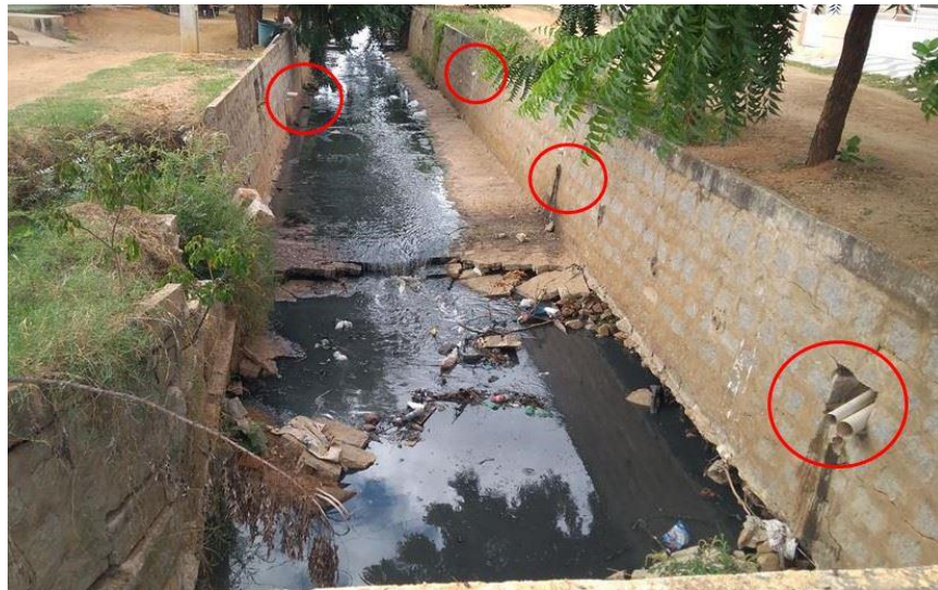
Foto 03. Ligações clandestinas de esgotos domésticos no sistema de drenagem pluvial.
